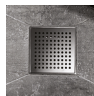
Etanchéité de l'installation
